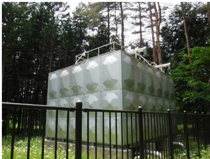
上水道 アルプス接合井（原水供給井）
