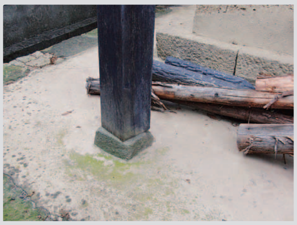
旧中村家住宅土蔵のさすじり柱のずれ
