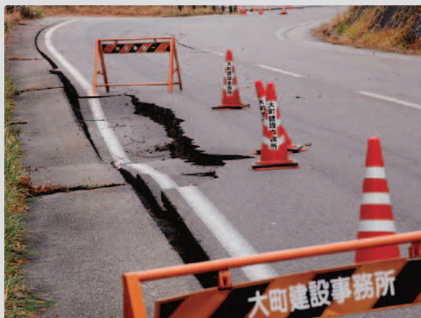
主要地方道長野大町線の路肩陥没
