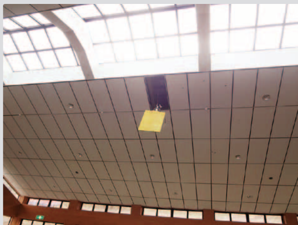
ぽかぽかランド美遊の天井ジプトーン落下
