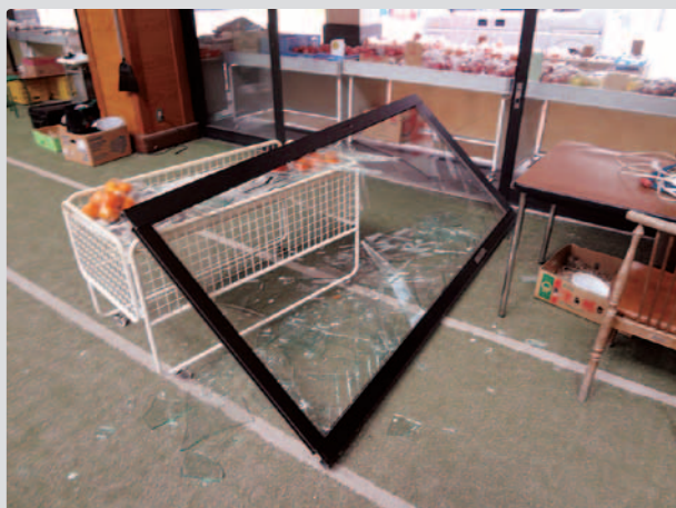
ぽかぽかランド美遊のアルミサッシドア破損
