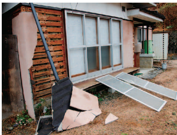
美麻青具川手地区の住宅被害
