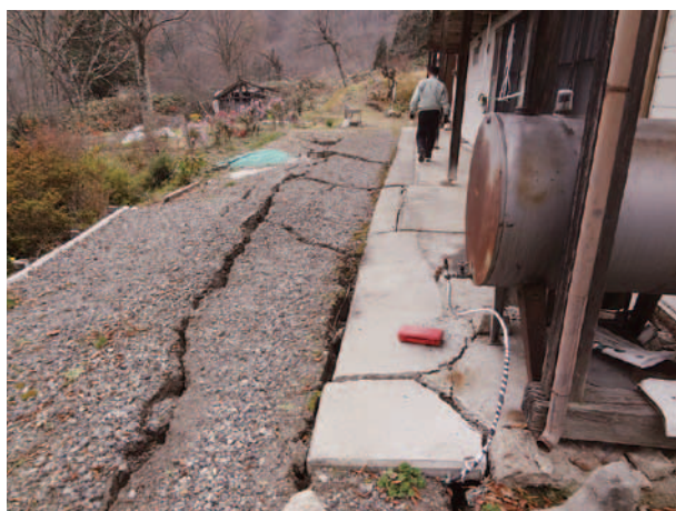
美麻青具峠地区の住宅敷地に亀裂
