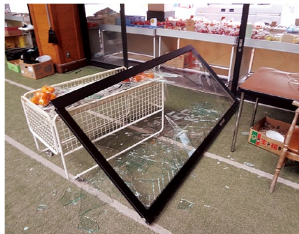
ほかほかランド美遊のアルミサッシドア破損
