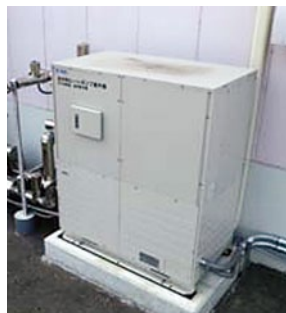
地中熱ヒートポンプ機器
