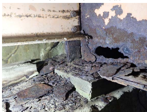
健全度Ⅳ：一字田1号橋
