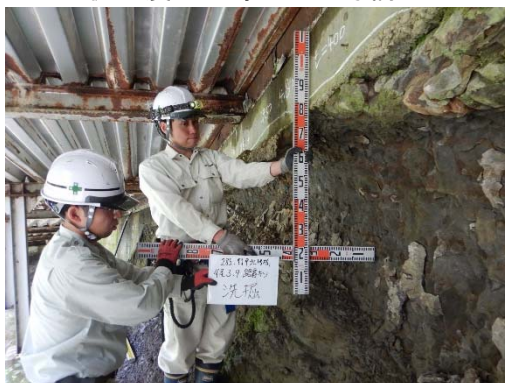
健全度Ⅲ：野平北1号橋
