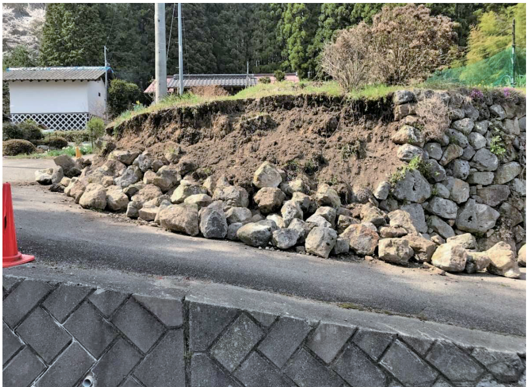
4月18日の地震。八坂大平集落では石積みなどが崩落した
