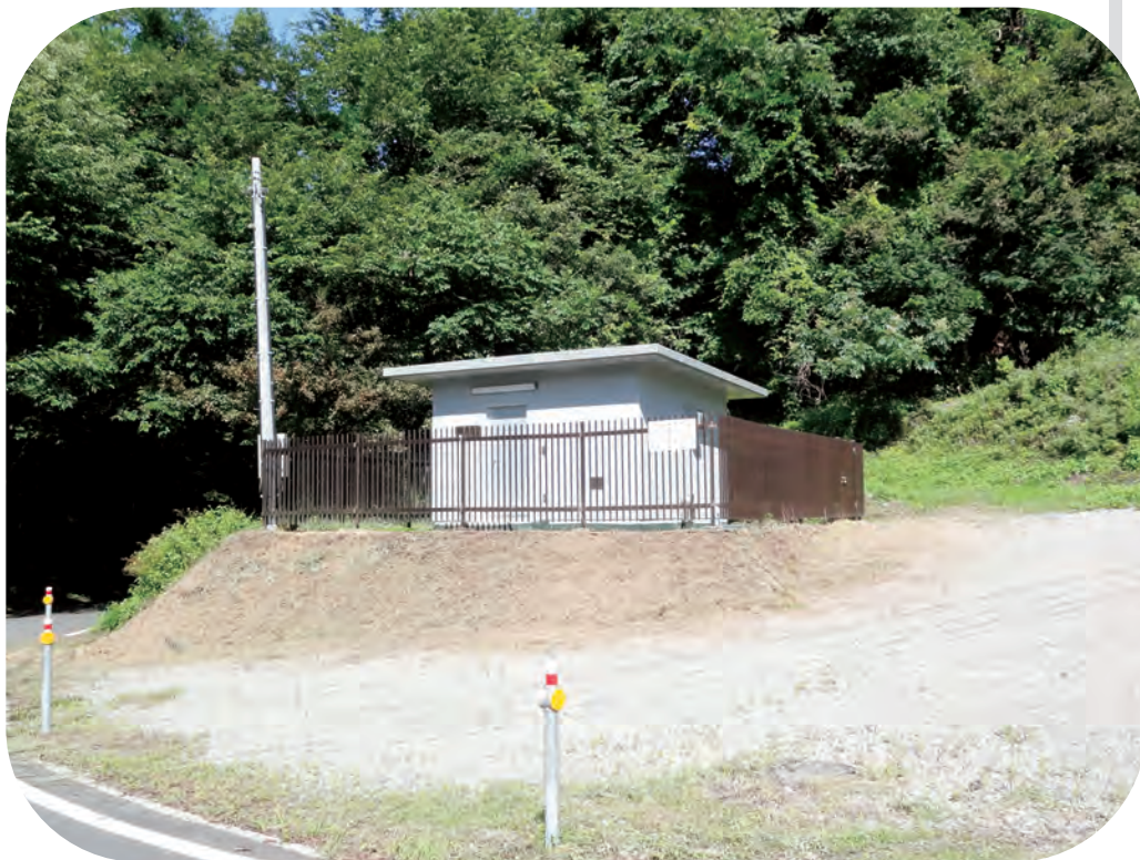
簡易水道 小菅送水ポンプ室
