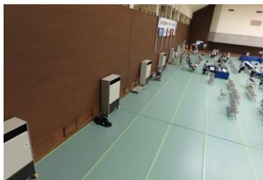
【仮設空調と養生の状況】
