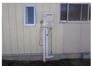
給湯器の設置
